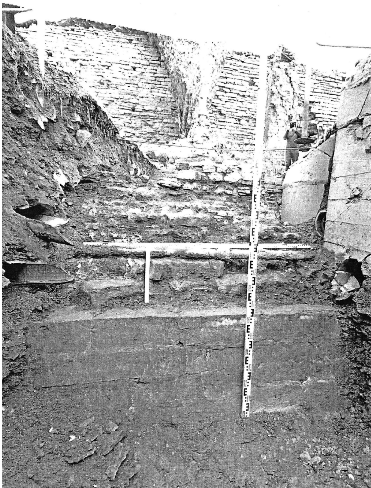
Рис. 6. Нумерные казармы. Южный фасад и стенка Водопроводного канала. Фотофиксация №86 на момент окончания работ. ИИМК РАН 2018 г.
